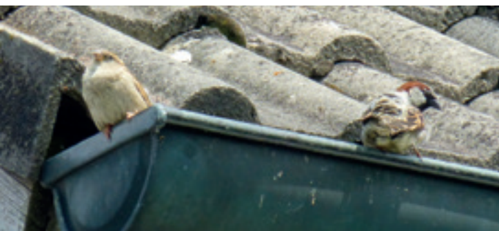
Der Spatz nutzt gerne Schlupfwinkel unter Häuserdächern. Nach einer Sanierung sind diese Lücken oft geschlossen, Foto: S. Rudolph
